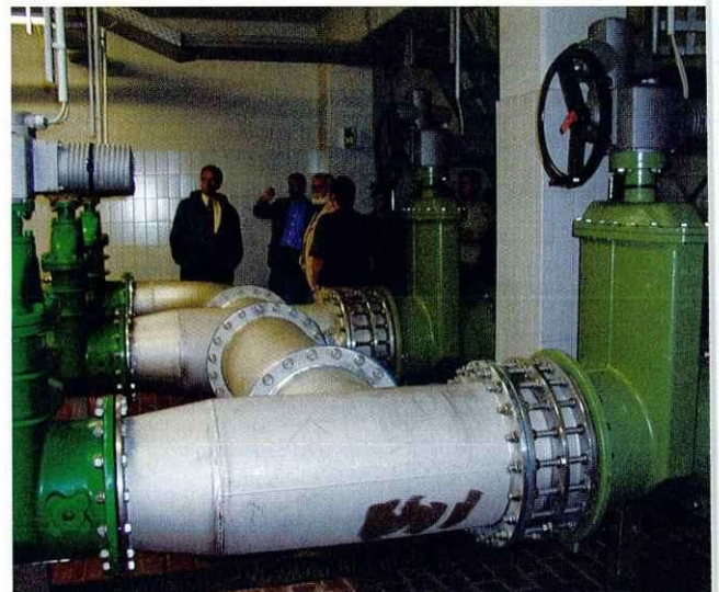
Hauptpumpwerk „Nord“ Besichtigung...
