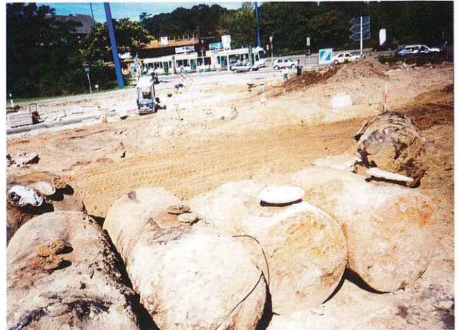
Reste einer ehemaligen Tankstelle am Standort des heutigen ZOB
