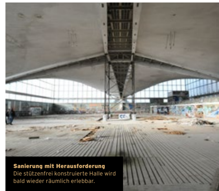
Transparente Fassade für die Hyparschale Eine moderne Veranstaltungsstätte entsteht dieser Tage auf der Rotehorninsel.
