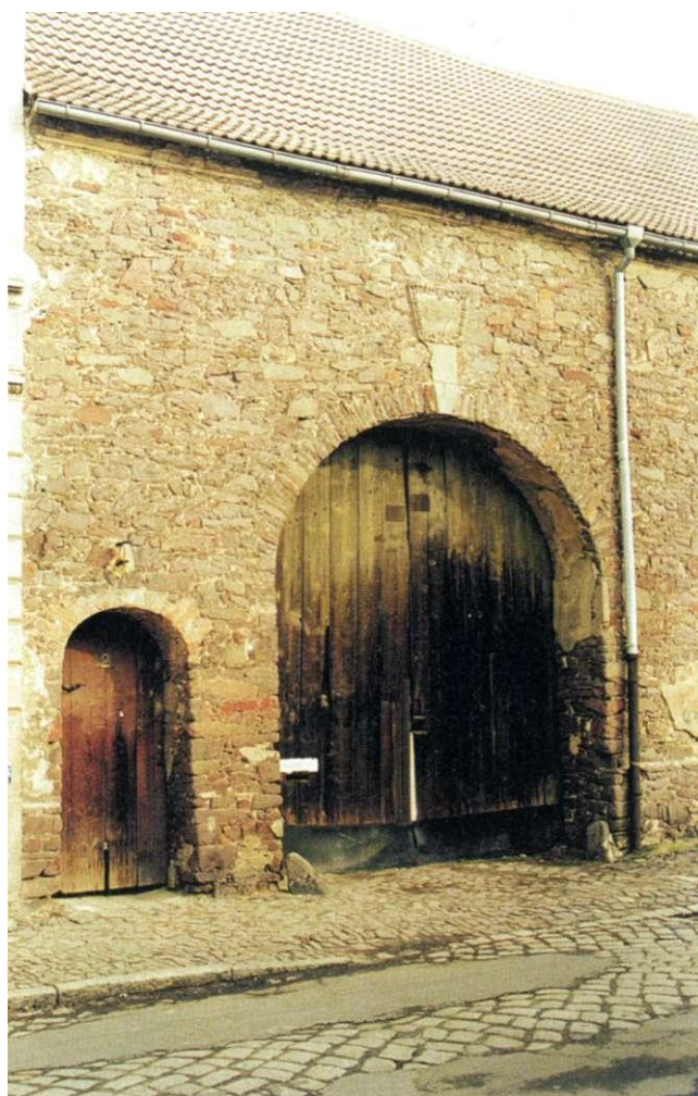
Rundbogentoreinfahrt und Schlu pftür, Dorfstrasse 2. Tür und Tor in der typischen schlichten Holz ausführung.
